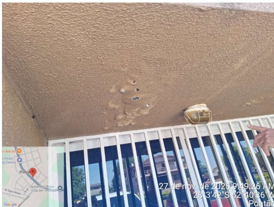
Imagem 22: Foto da textura soltando na parte inferior da laje.
