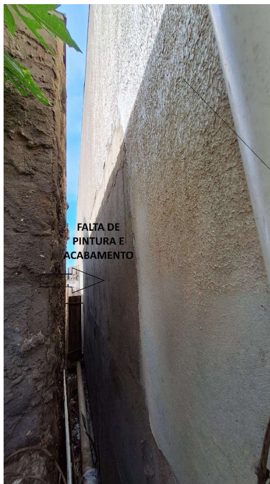
Imagem 37: Foto da parede nos fundos da edificação, sem textura e pintura.
