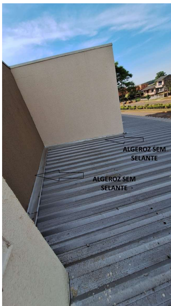
Imagem 19: Foto do coberto da frente da edificação sem os selantes nas latas.
