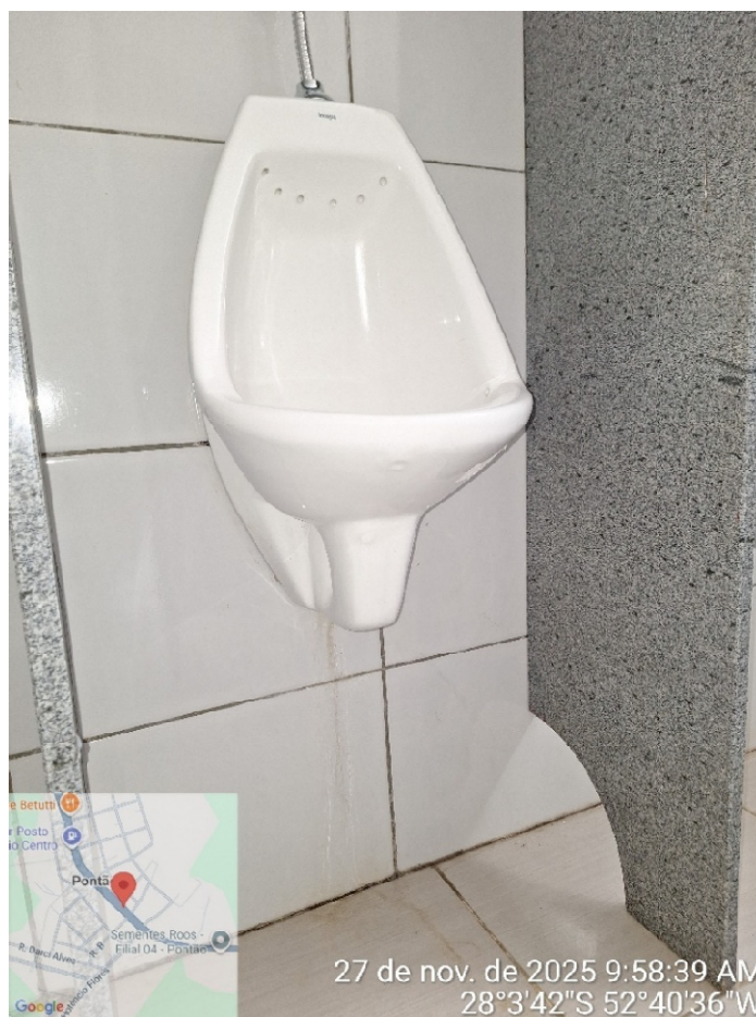
Imagem 36: Foto do Mictório com vazamento na parte inferior.
