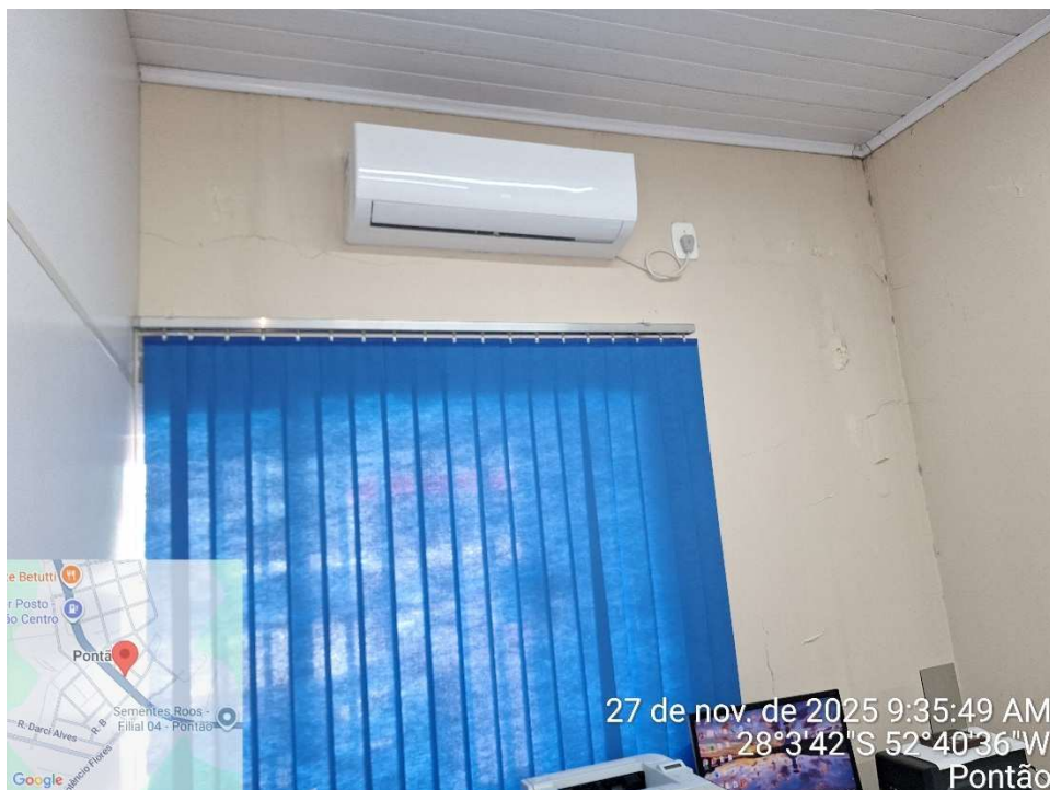
Imagem 31: Foto da umidade na sala do assessor de imprensa.
