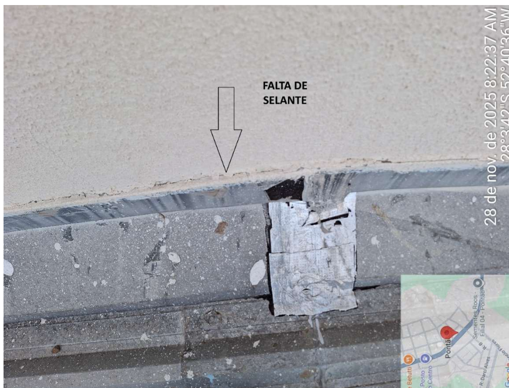
Imagem 20: Falta de selantes nas latas no coberto do administrativo.
