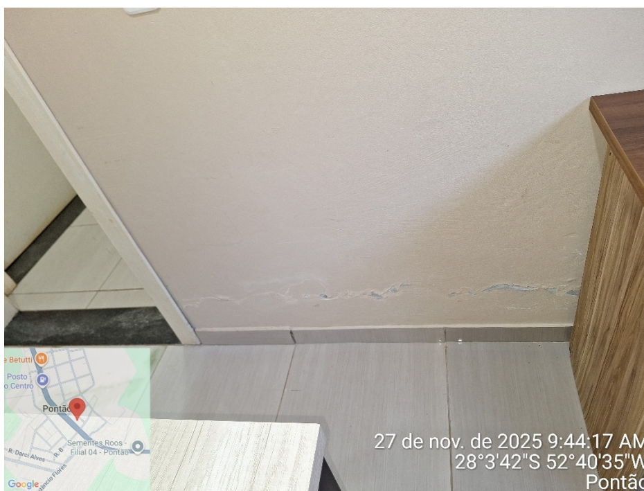
Imagem 34: Foto das paredes no depósito.
