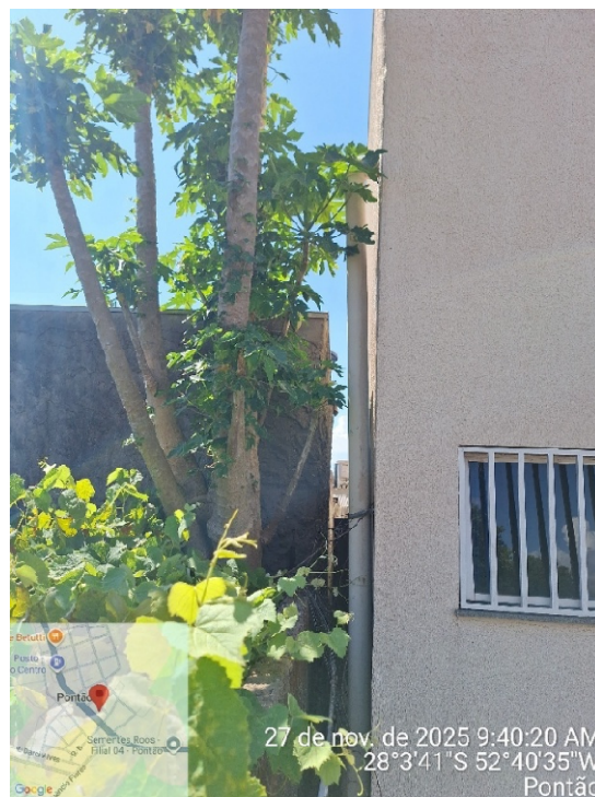
Imagem 38: Foto da parede nos fundos da edificação, sem textura e pintura.
