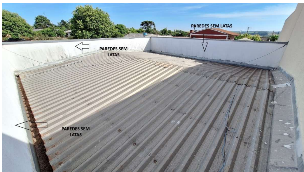
Imagem 18: Foto das paredes sem latas no telhado da parte administrativa.
