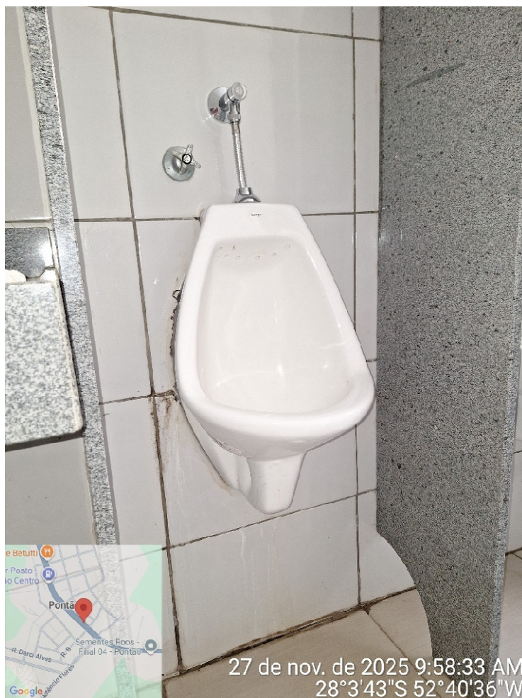
Imagem 35: Foto do Mictório com vazamento na parte inferior.
